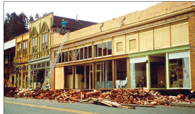
Ladrillos del mismo edificio se cayeron durante el terremoto de abril de 1992. Actualmente el edificio ha sido reemplazado por una estructura de madera.
